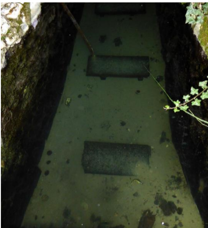
Le sol noyé de la galerie d'entrée, à comparer avec la photo de la page 2.
