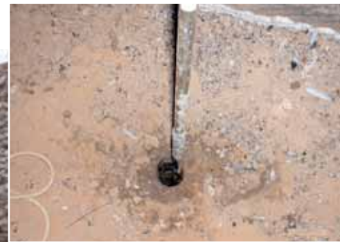
Au fond de quatre puits, des sondages ont été effectués à la tarière à main. Au bout de 2,3 m au maximum, ils ont buté sur le fond rocheux. Dans le sondage 1 (ci-contre) on distingue à 70 cm du sol un changement de couleur dans la roche qui pourrait indiquer le niveau de l'eau dans les années 1950. Elle est aujourd'hui trois mètres plus bas. Clichés Paul Courbon.
