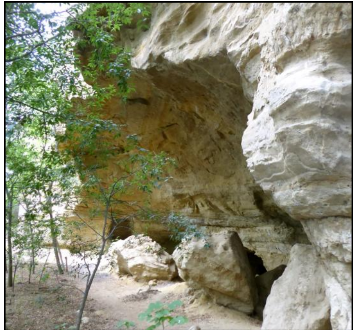
L'effondrement de blocs a amené une purge de la falaise.
