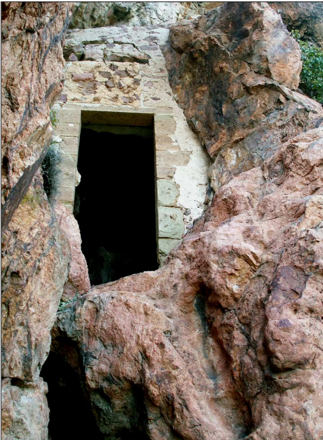
Fig. 13 : La porte suspendue au dessus de la grotte de l'Hôpital est visible de loin. Le plancher qui la suit ayant disparu, elle donne sur 8 m de vide!
