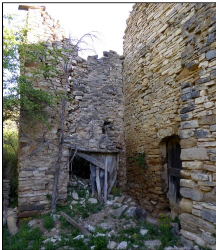
En haut, l'éboulement des pierres empêche de voir l'agencement intérieur du moulin.
